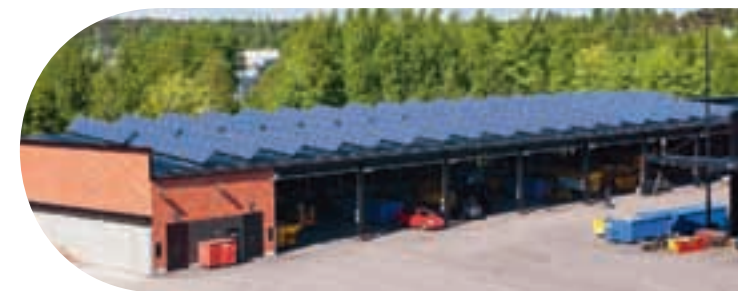
Naps-aurinkosähköjärjestelmä Espoon kaupungin autovarikolle sähköautojen lataamiseen. Järjestelmän tuotannolla katetaan 10-15 sähköauton arvioitu vuotuinen energian tarve. Järjestelmä syöttää sähköä kiinteistön verkkoon, josta sähköautojen lataaminen tapahtuu. Järjestelmän huipputeho on 55 kilowattia.
